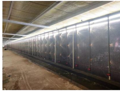
图 2 末端排风喷雾除臭
